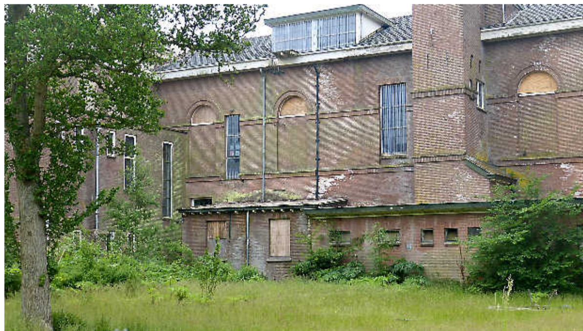
Groen uitgeslagen muren bij rijksmonument Meerenberg in Park Brederode.
